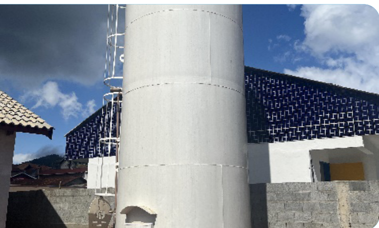
Detalhe do reservatório de 15.000 l
