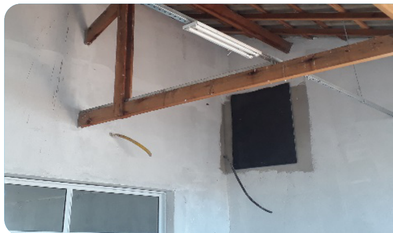
Detalhe da instalação elétrica
