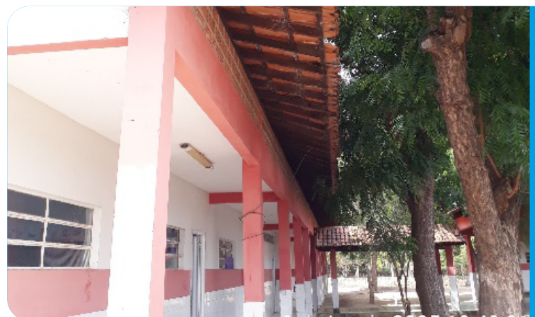
Detalhe da ausência de telhas no beiral da cobertura
