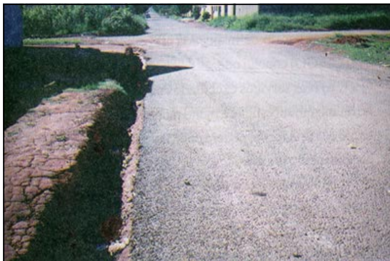
Ausência de meio fio provocando erosão
