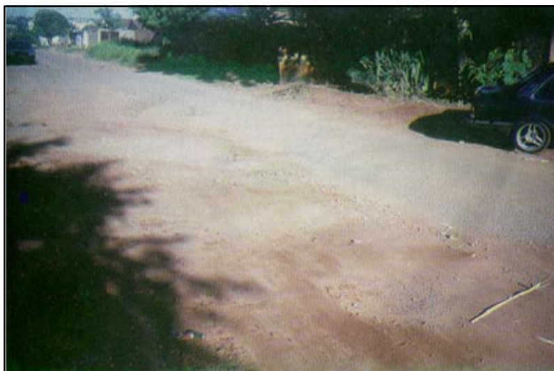
Via de tráfego de ônibus: presença de terra sobre o asfalto, buracos e ausência de meio fio
