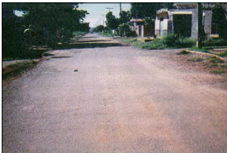
Ausência de meio fio
