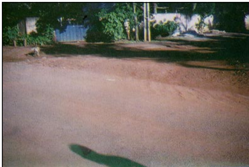
Presença de terra sobre o asfalto
