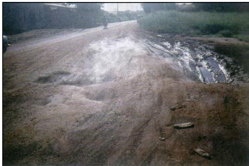
Via de tráfego de ônibus: presença de buracos e ausência de meio fio
