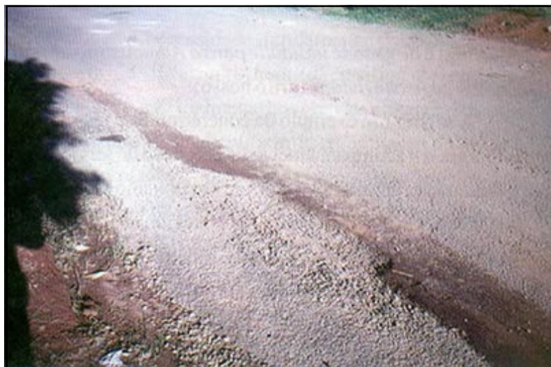
Via de tráfego de ônibus: presença de buracos e material desagregado
